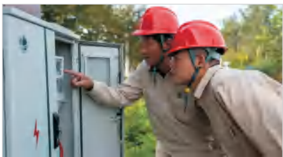
图6. 查看泵站表记装置
